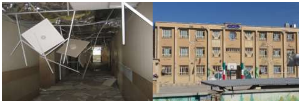
شکل ۳. آسیب دیدگی تعدادی از مدارس در زلزله ۱۳۹۶ سرپل ذهاب
